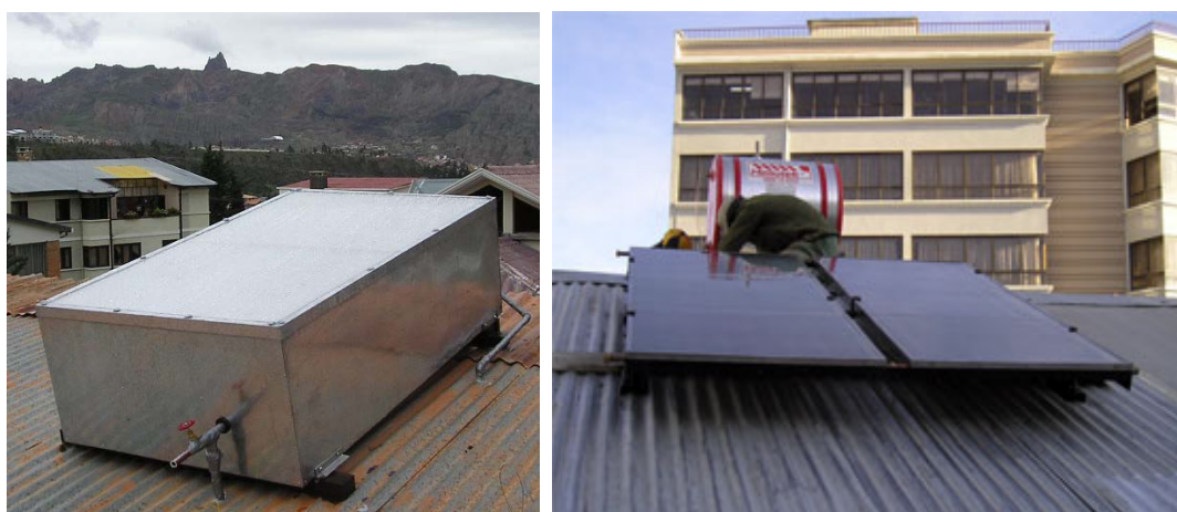
Fotografías 3 y 4: Izquierda: Calefón solar compacto. Derecha: Instalación de un calefón solar con colectores planos y tanque de agua caliente separado.
