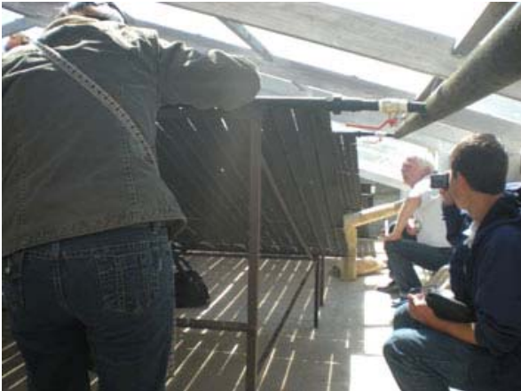
Demostración del sistema de calefones solares
